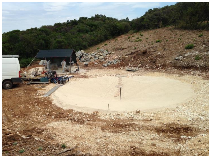
Atelier de taille de pierre sur le site de construction de la lavogne au lieu-dit "le Pavillon" (source : SMGG)
